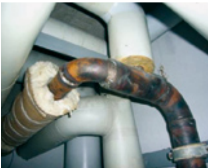
Unzureichend gedämmte Heizungsleitungen.
